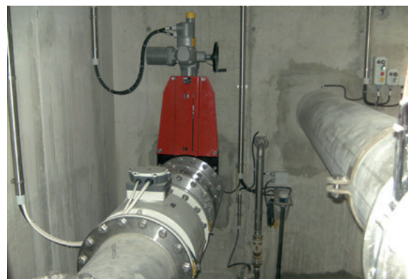
Abb. 5: Regelstrecke (MID und Regelschieber) an einem Beckenablauf
