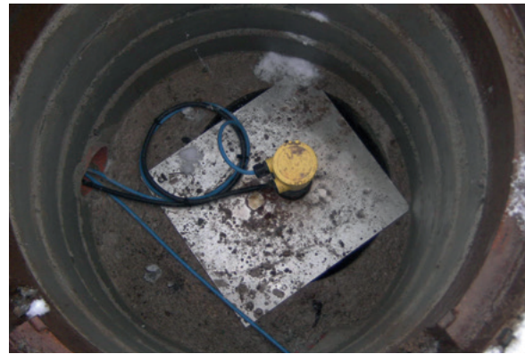
Abb. 2: Wartungsfreundlicher Einbau einer Radar-/Ultraschallsonde
